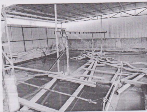
图 3-1 生产废水沉淀池
