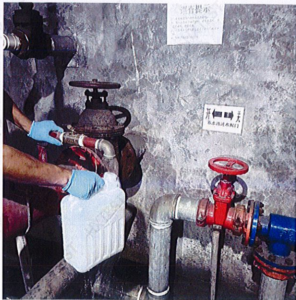
城北嘉乐园自来水池监测点（二次供水）
