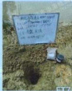
污水沉淀池 ET7
